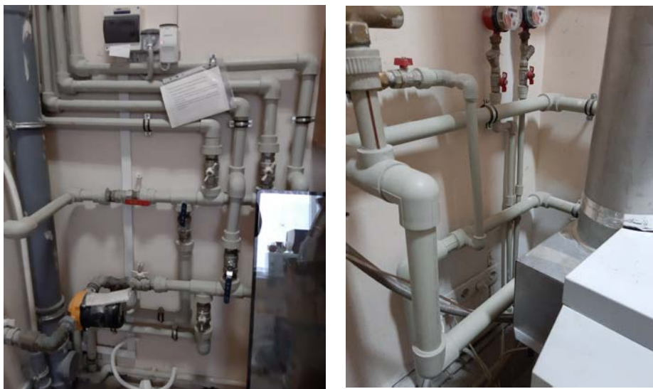
Рис.3.5. Стан ізоляції трубопроводів у спортивному клубі
