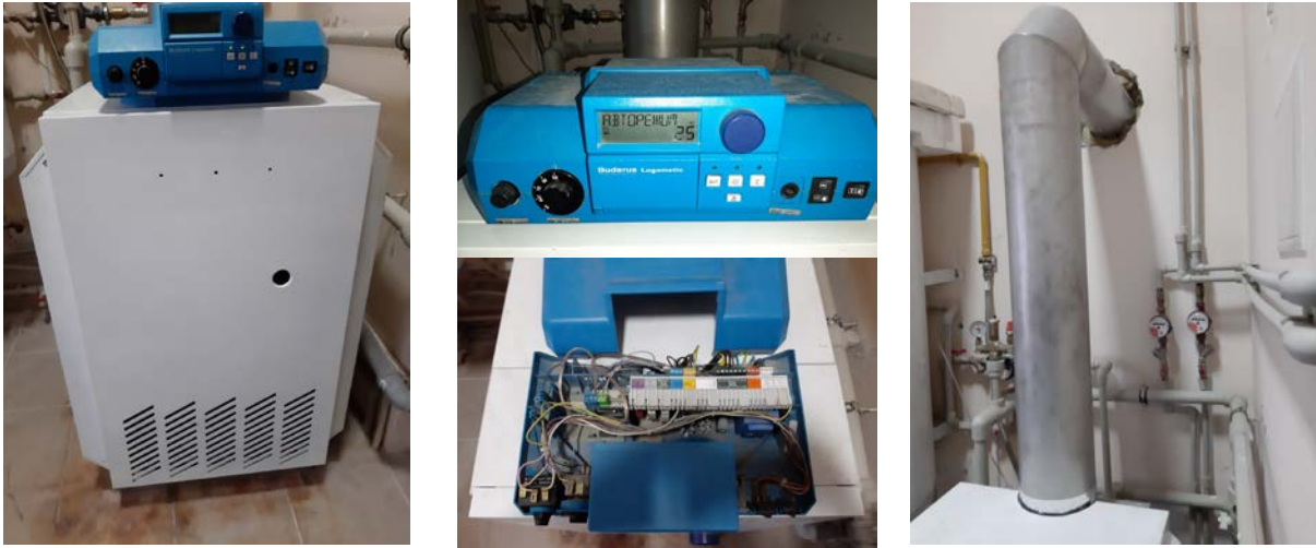
Рис. 3.7. Фото пункту теплопостачання (котел) у спортивному клубі
